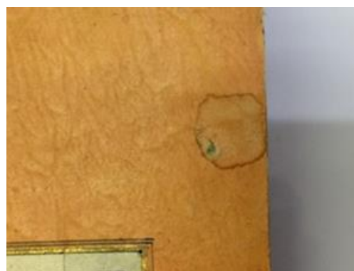
لکه های ناشی از نفوذ رطوبت
