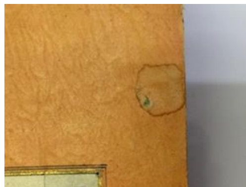
لکه های ناشی از نفوذ رطوبت
