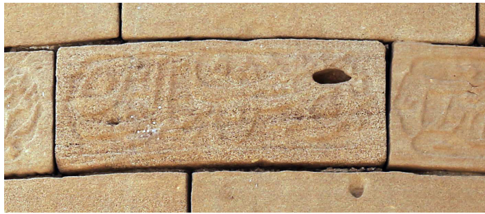
تصویر ۱۰. به کار بردن سنگ نامرغوب و فرسایش شدید آن
