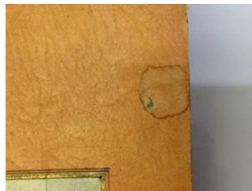
لکه‌های ناشی از نفوذ رطوبت
